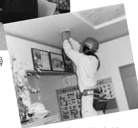
電気設備点検
