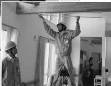
電気器具の 清掃・点検
